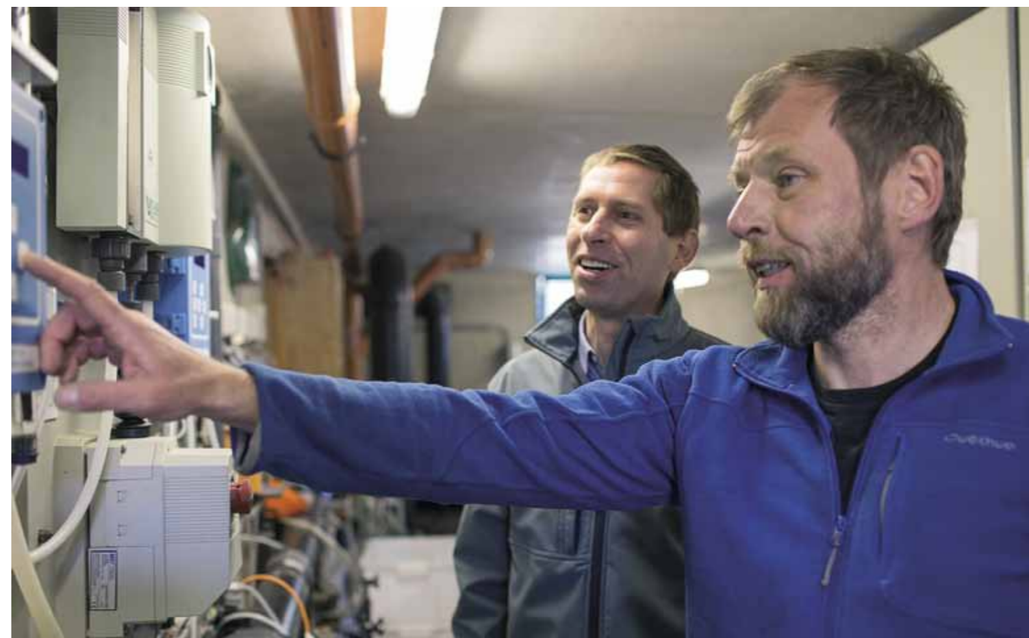
Ralf Becker (re.) und Volker Mertens-Busch bei der Kontrolle der Anlagen.
