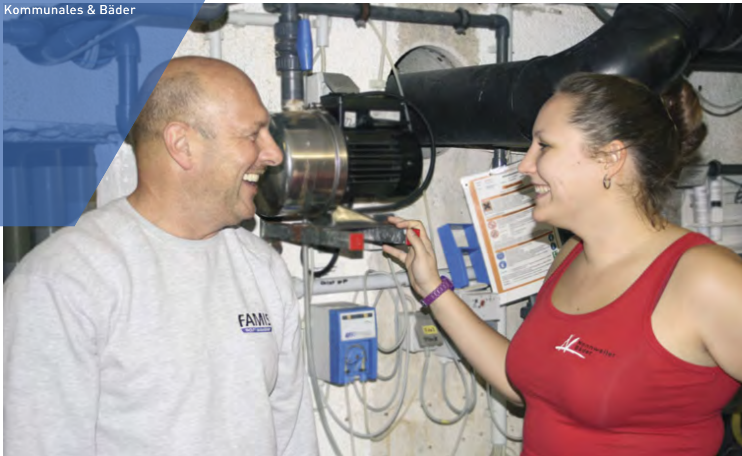
Lisa Wagner, Betriebsleiterin der Nonnweiler Bäder, freut sich mit Gerhard Zajonz von der FAMIS über die Energie-Einspar-Idee im Hallenbad, die im Rahmen des Ideenmanagements prämiert wurde.
