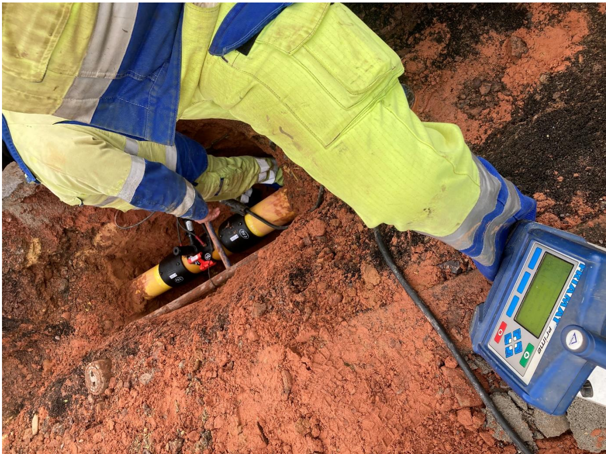
Das Bild zeigt die Schadensstelle. Bild: energis Netzgesellschaft
